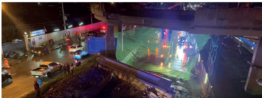
ภาพเหตุการณ์หลังแผ่นปูนหนัก 5 ตัน หล่นจากสะพานกลับรถถนนพระราม 2
