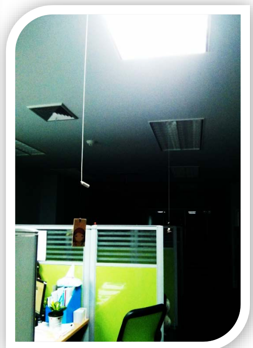
การใช้ระบบ ปิด-เปิดไฟ เฉพาะจุด
