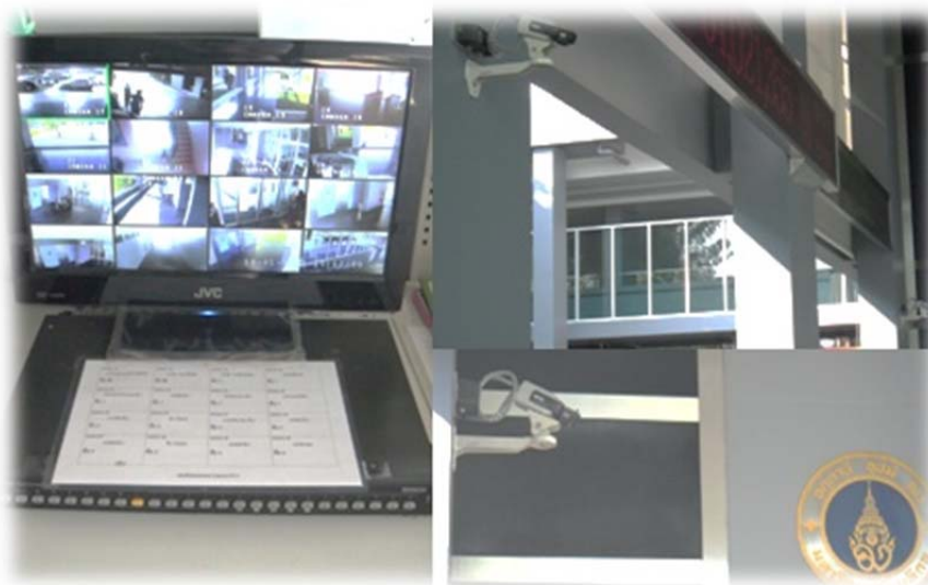
ระบบ CCTV ของสถาบันฯ
