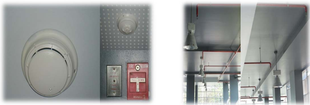
ระบบแจ้งเตือนเหตุอัคคีภัยและระบบดับเพลิงอัตโนมัติ
